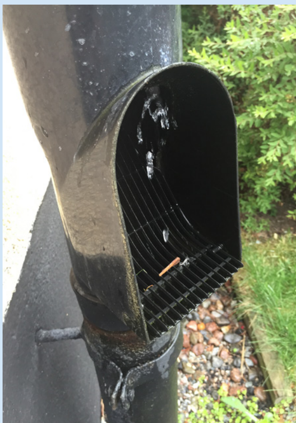
Lövsil monterad på stuprör.
